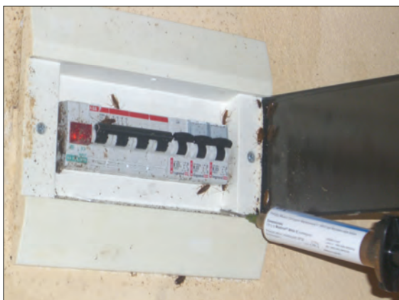
Figura 5 Applicazione in pannello elettrico
